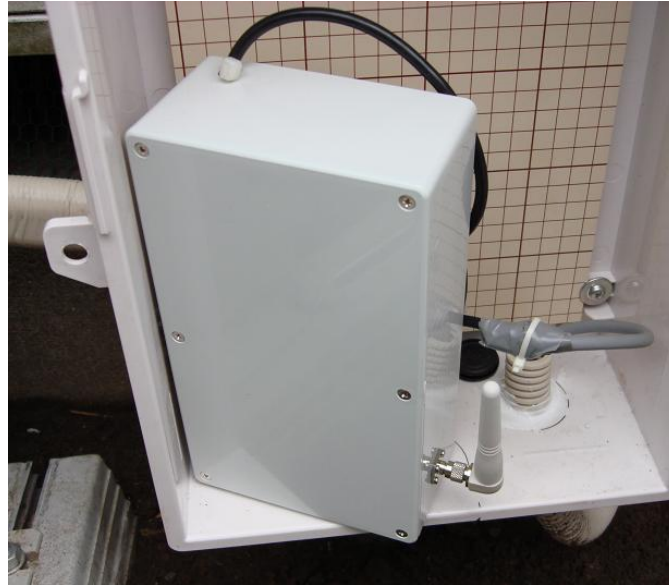
図 4-49 ガスメータ、水道メータ通信用の無線ボックス（雨、露を防ぐプラスチックボックス内に収納し、電池駆動）
